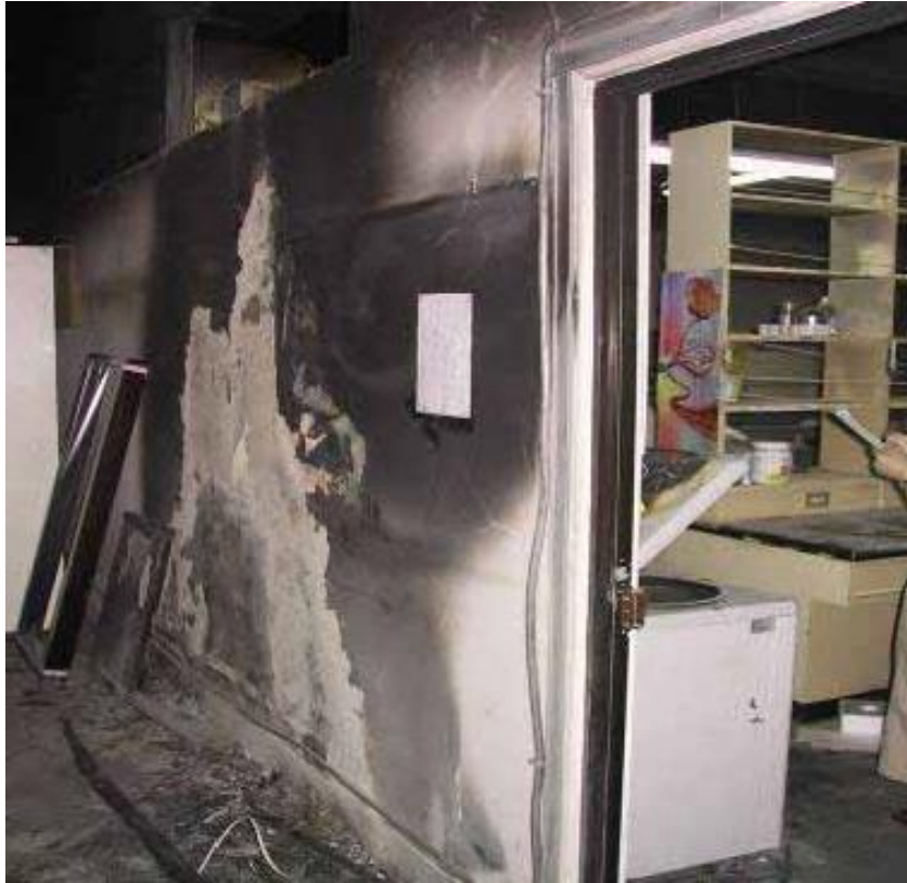
某實驗室火災現場
